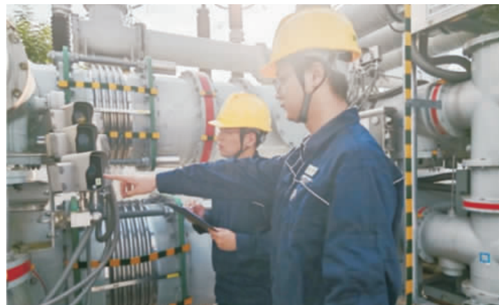
运维人员检查巡视设备区运行情况。
